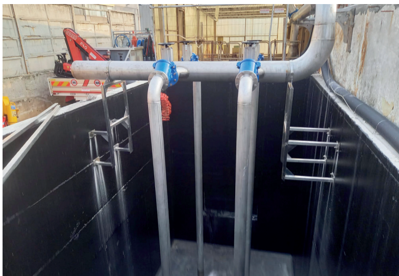
Ampliamento della vasca di arrivo dei reflui
