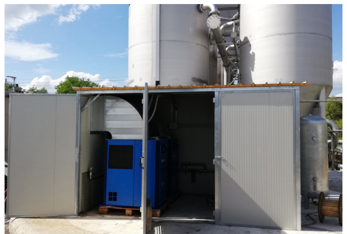
I nuovi compressori a servizio dei filtri
