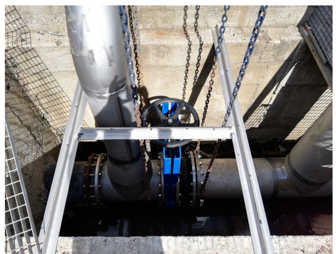
Particolare del collegamento idraulico
